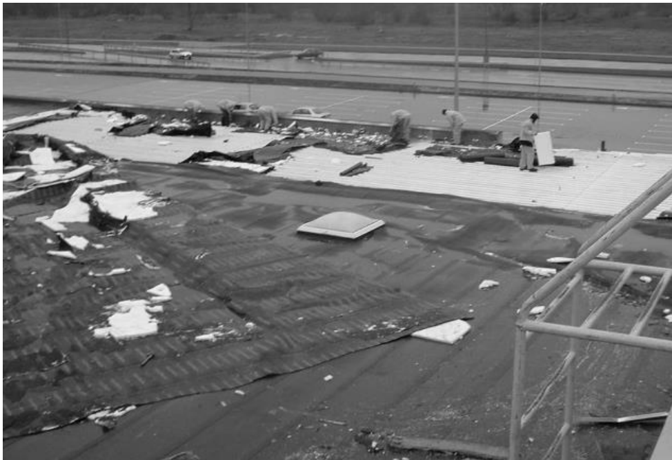
36 pav. Vėtros nuplėštas nepatikimai sutvirtintas prekybos centro plokščiasis stogas
