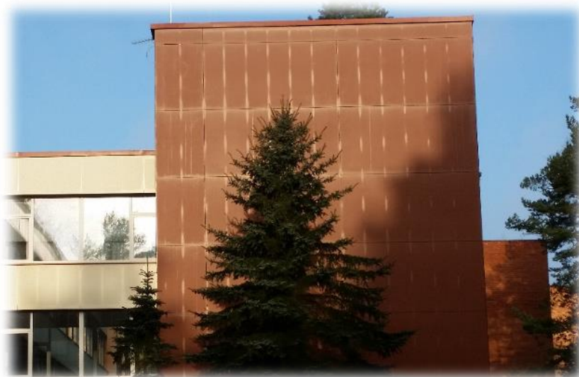
26 pav. Pastato fasadas, dėmėtas dėl netinkamai įrengto metalinio karkaso vėdinamoje šiltinimo sistemoje
