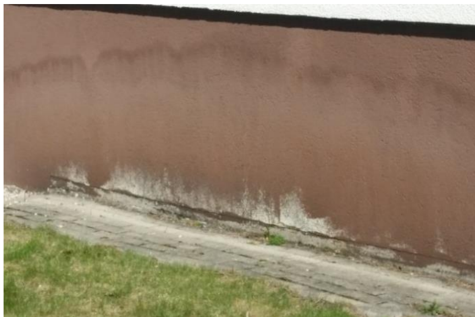
3 pav. Cokolio gendanti tinkuota sudėtinė termoizoliacinė sistema, esanti prie uždarnosios nuogrindos, po trejų metų
