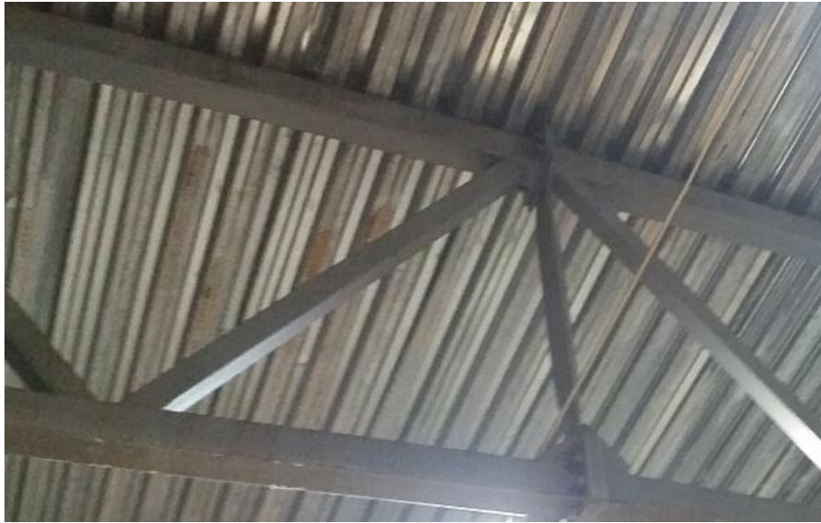
40 pav. Maisto produktų saugyklos stogą laikanti santvara, ant kurios pro profilinio pakloto plokščių galus teka drėgmės kondensatas
